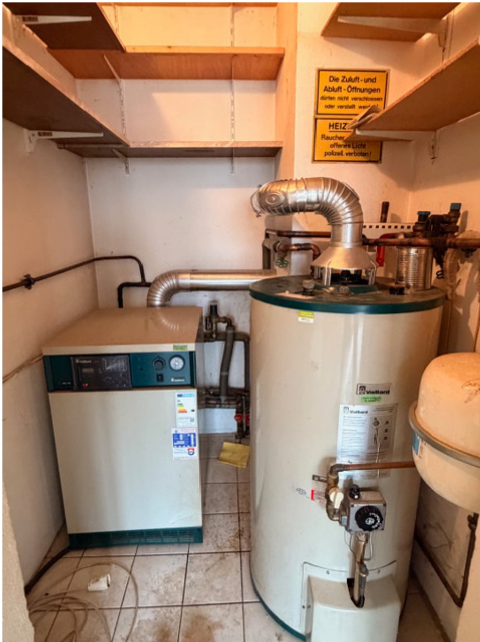
Heizungsraum im Erdgeschoss
